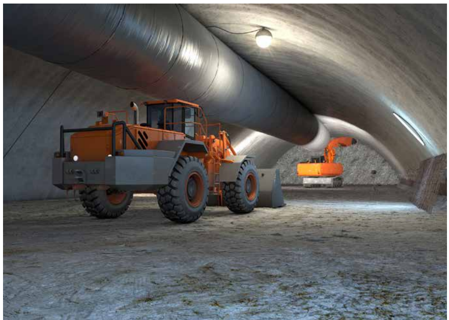
Abb. 139 Belüftung im Kalottenvortrieb
